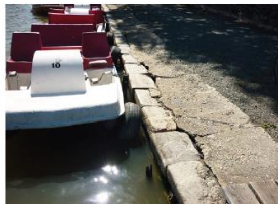
Les vieilles boutisses en grès qui marquent la rive du quai doivent être impérativement conservées et reposées dans le cadre de la rénovation à court terme de cet ouvrage.
